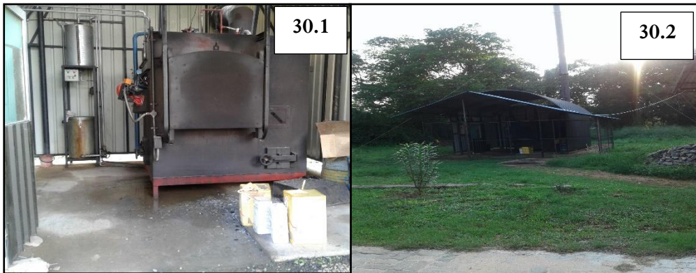
කන්තලේ රෝහලේ හඡමකය (Incinerator)
